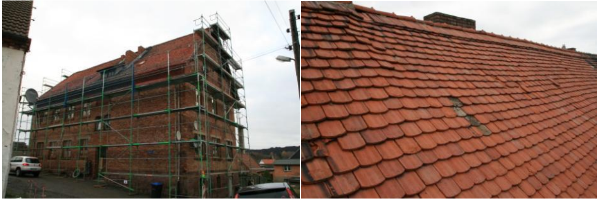
28.11.2013 Dacheinrüstung und desolates Dach der Wochenstube des Großen Mausohrs „Alte Schule“ Ahlsdorf, LK Mansfed-Südharz
